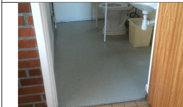
Bild 12: Prov 26, grå plastplatta på WC plan 2. Ej asbest.
