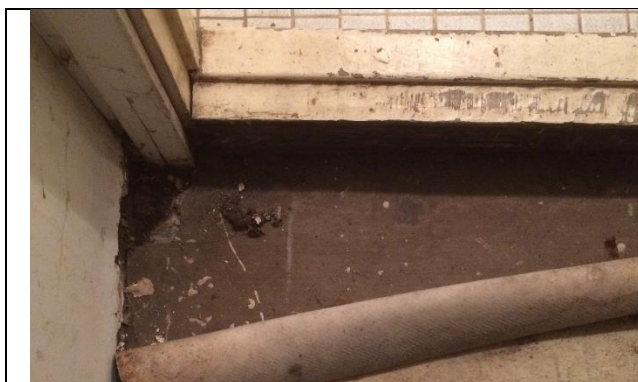
Bild 10: Prov 10 och 11, brun plastmatta och mattlim på källarplan. Asbest i plastmattan.
