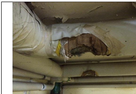
Bild 14: Provtogs 3, Tjockare rörisolering i pannrum på pannrumsplan. Ej asbest.
