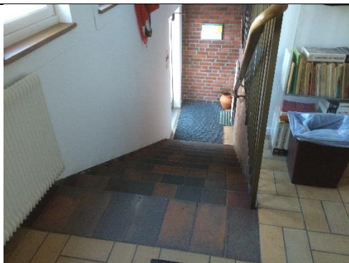
Bild 9: Prov 28, klinkerfog i kapprum/ trappa mellan plan 1 och plan 2. Ej asbest.
