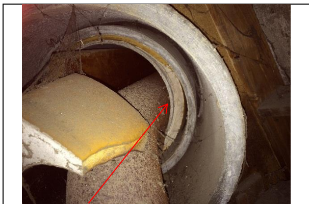
Bild 16: Rör i oåtkomlig trumma i ytterväggen i nordvästra hörnet av källarplan. Misstänkt förekomst av asbest.
