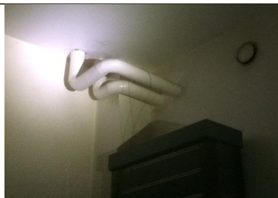
Bild 15: Provtogs 21, Rörisolering i rörkrök i butikens lagerutrymme på plan 1. Asbest.
